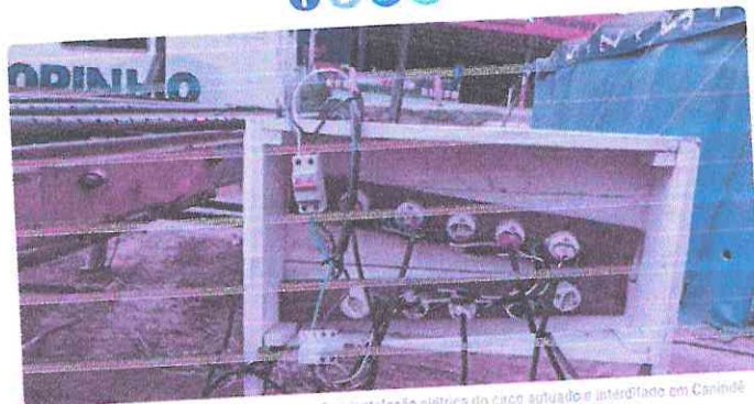
Bombeiros apontaram "índices de gambiarras" na instalação elétrica do carro acionado e interditado em Canindé. Crédito: DIVULGAÇÃO CORPO DE BOMBEIROS
